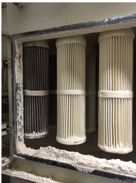
Filter links in beeld na het pulsen. Duidelijk beter ontstoft na het pulsen
